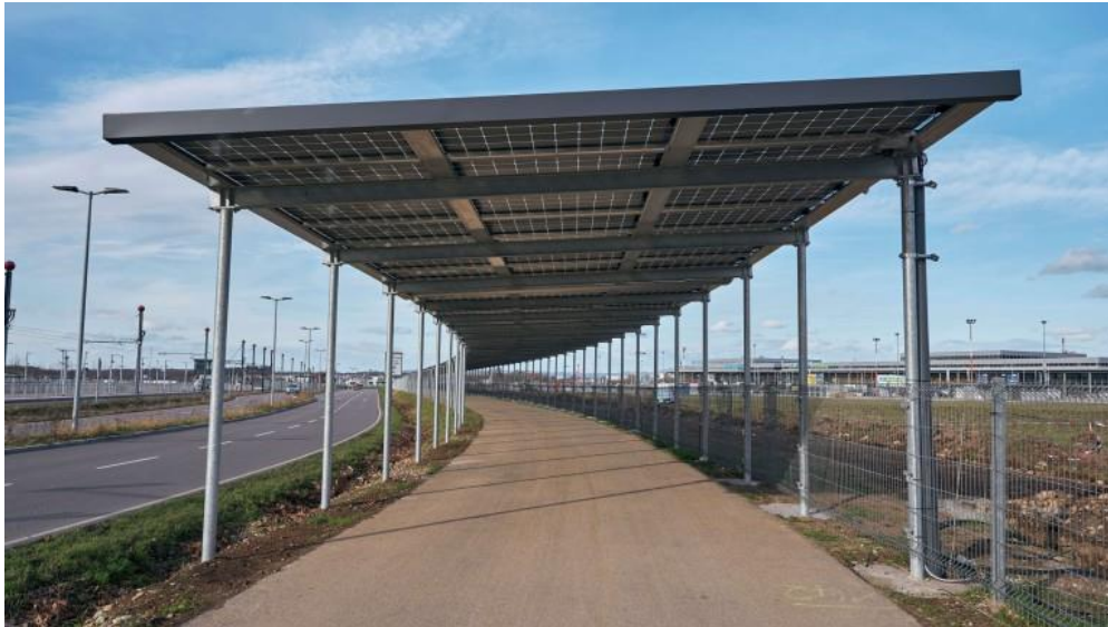
Abbildung 4: Beispiel Radwege-PV. Solar Radweg in Freiburg. Quelle: Badenova ( https://www.badenovawaermeplus.de/bilder/erneuerbare/sonne/solarradweg/pv-radweg_pic_768.jpg?ts=1682431285295 )
