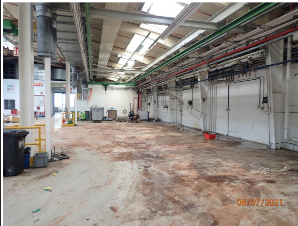
Bild 5: Innensicht EG Halle 1 mit veröltem Betonfußboden (Datum: 08.07.2021) (Blickrichtung Süd)
