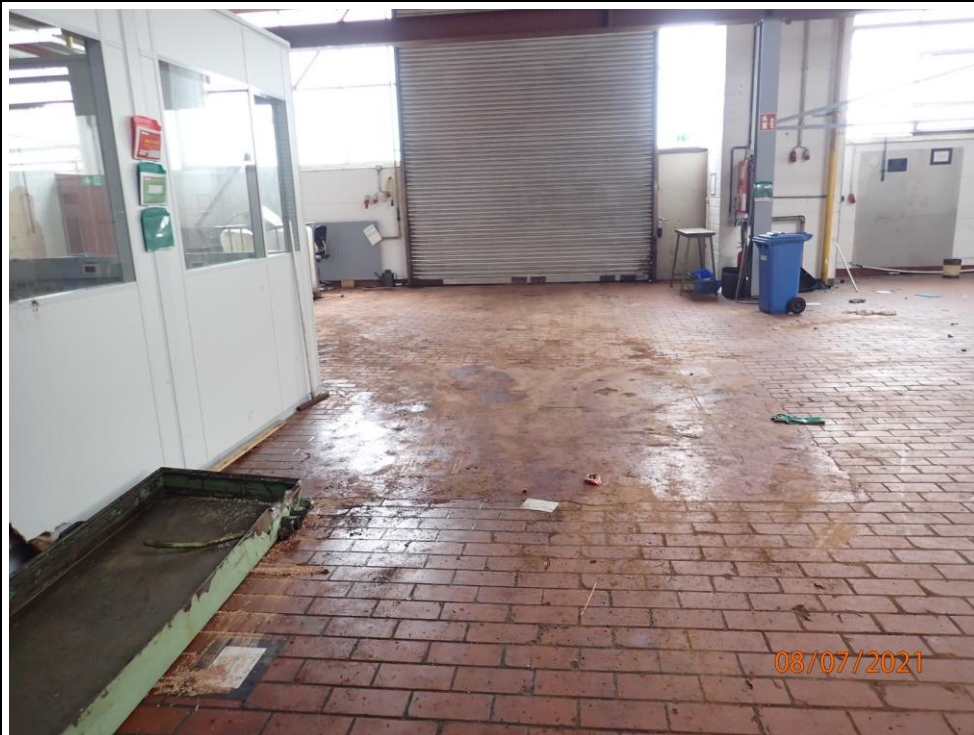
Bild 6: EG Nordteil (Formenbau) von Halle 1 mit veröltem Fußboden, früher Lackiererei (Datum: 08.07.2021) (Blickrichtung Nord)
